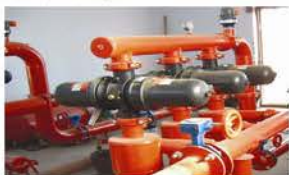
高泥沙河流滴灌供水首部系统
